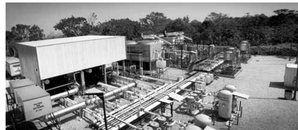
Planta de Inyección de aire. Villahermosa, Tabasco.
