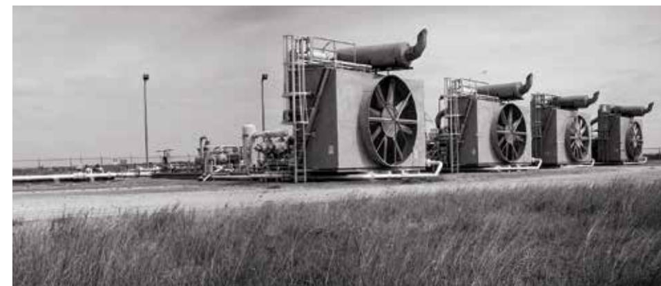
Palmito 3. Estación de compresión de gas.
